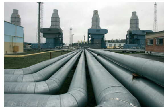
■ Nesviž (Bělorusko) – Přečerpávací kompresorová stanice plynovodu Yamal-Evropa v Bělorusku – Nesviž – leží asi 150 km jihozápadně od Minska. Majitelem je však ruský Gazprom.
