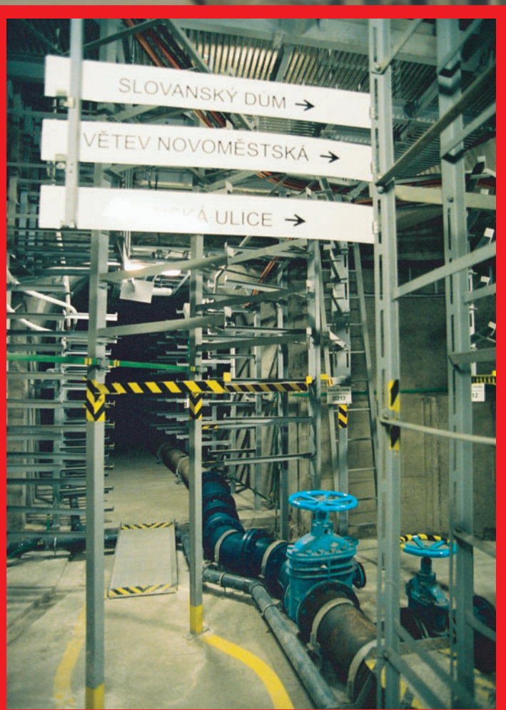
■ Kolektor na Příkopech
