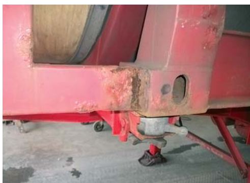
Zrezivělý a popraskaný přední rám
